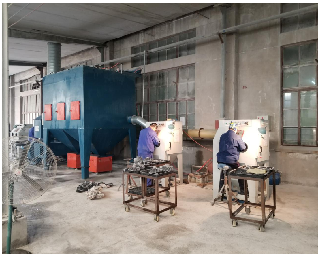
喷砂打磨配备的除尘器
